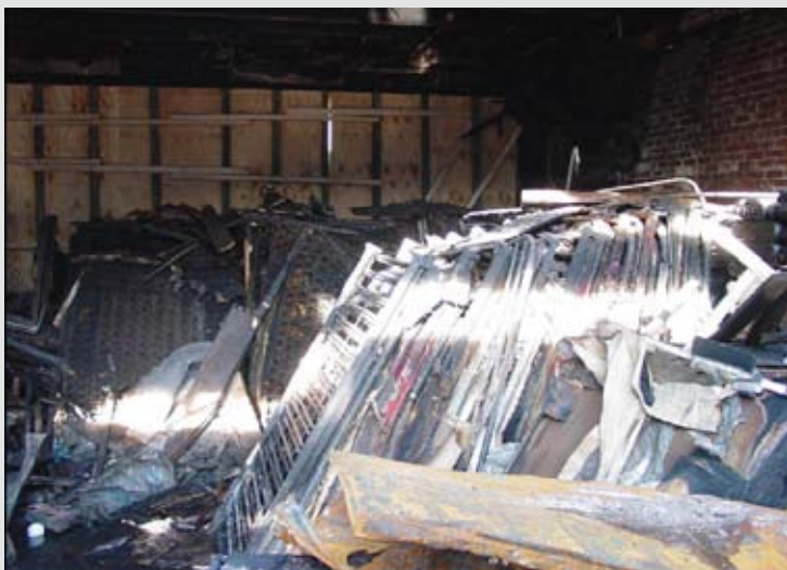
Fot. 2.3. Magazyn mebli po pożarze.
