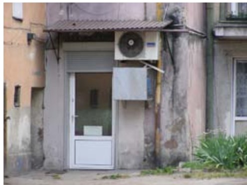
Fot. 4.14. Klimatyzatory oraz antywłamaniowe żaluzje.
