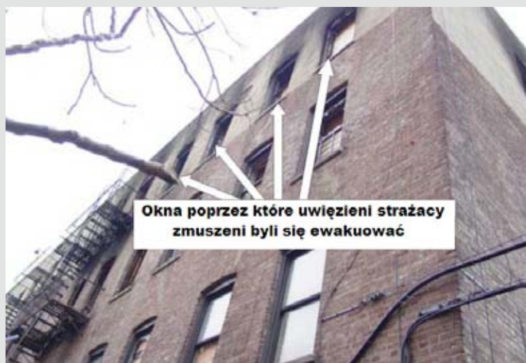
Fot. 3.2. Okna tylnej części budynku, z których uwięzieni strażacy zmuszeni byli skakać (Zdjęcie: NIOSH Report F2005/03, http://www.cdc.gov/niosh/fire/ ) [1]
