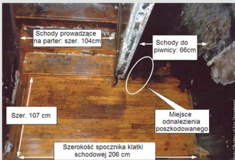
Fot. 7.3. Spocznik klatki schodowej na którym odnaleziono poszkodowanego (po uprzątnięciu). (Zdjęcie: NIOSH Report F2005/04, http://www.cdc.gov/niosh/fire ) [1]
